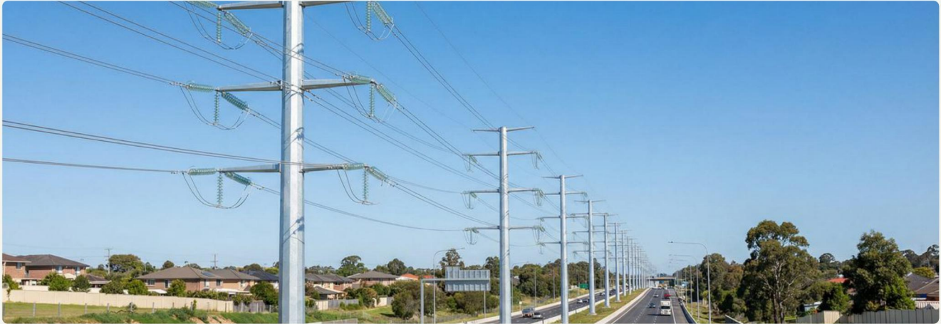
Postes octogonais 220 kV ao longo de rodovia — 36 m de altura, galvanizado a quente
