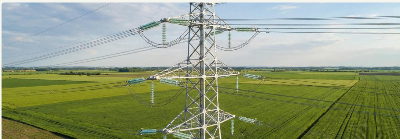
Torre treliçada de duplo circuito 500 kV — Q355B, galvanizada a quente, 65 m de altura
