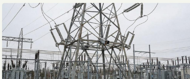
Torre Terminal (Dead-End) — terminação em subestação
