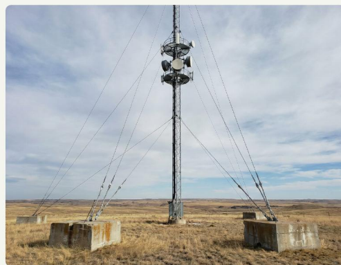
Mastro estaiado 80 m — estais de ancoragem, grande altura
