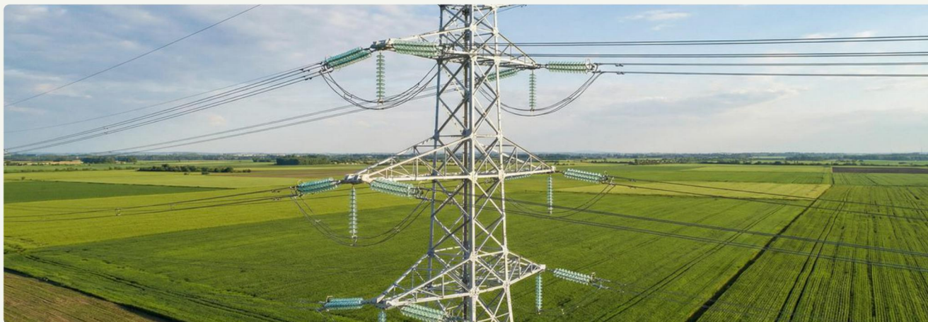
Tour en treillis double circuit 500 kV — Q355B, galvanisée à chaud, 65 m de hauteur
