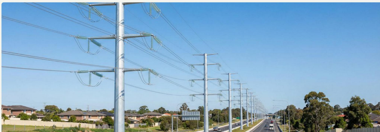
Poteaux octogonaux 220 kV le long d'autoroute — 36 m de hauteur, galvanisé à chaud
