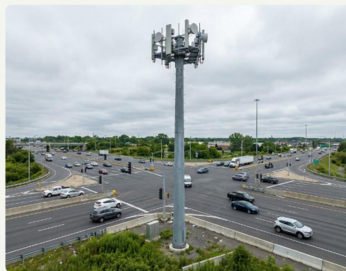
Monopôle conique 25 m à intersection d'autoroute
