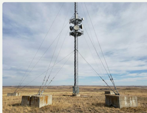
Mât haubané 80 m — haubans d'ancrage, grande hauteur
