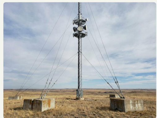
Mástil atenazado 80 m — vientos de anclaje, gran altura
