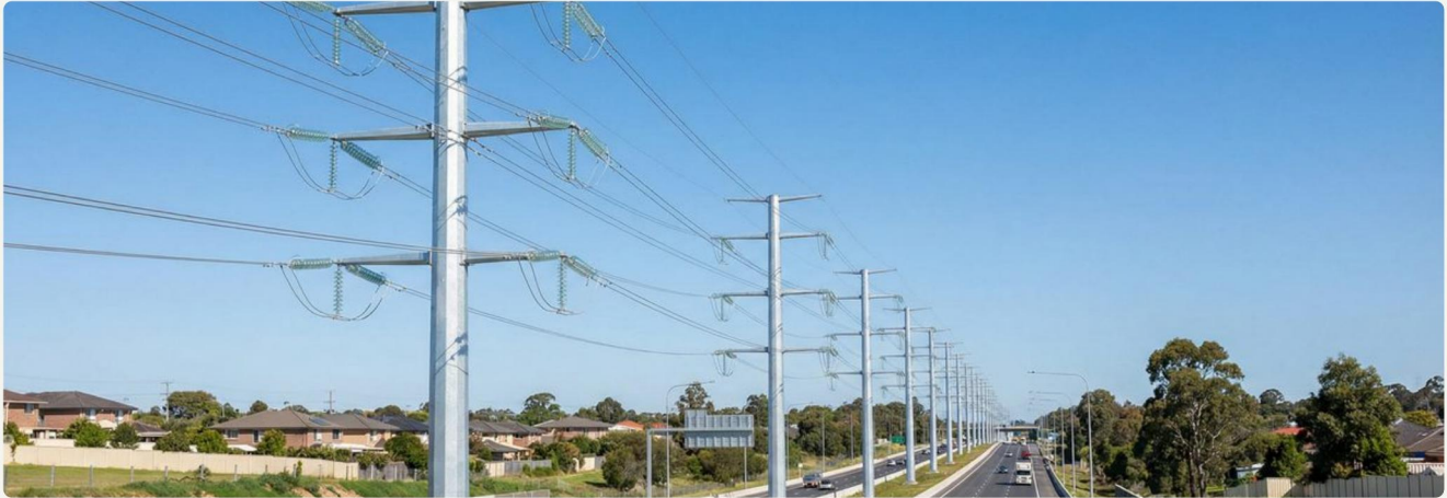
Postes octagonales 220 kV a lo largo de autopista — 36 m de altura, galvanizado en caliente
