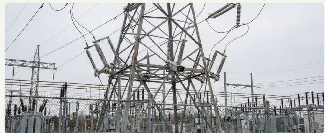
Torre Terminal (Dead-End) — terminación en subestación
