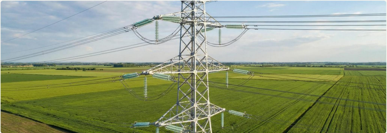
Torre de celosía de doble circuito 500 kV — Q355B, galvanizado en caliente, 65 m de altura
