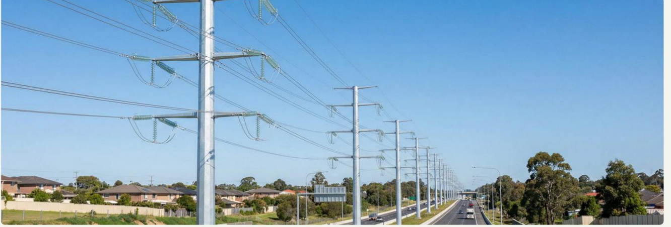
أعمدة ثمانية 220 ك.ف على طول الطريق السريع - ارتفاع 36 م، مجلفنة بالغمس الساخن
