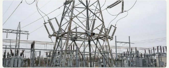
برج طرفي (Dead-End) - إنهاء في محطة فرعية
